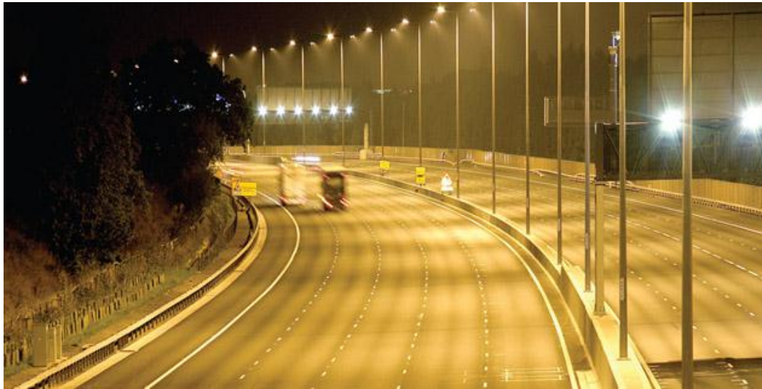
شكل (3-20) إضاءة الشوارع (www.lighting.philips.com)
